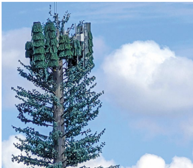
Les « pylônes-arbres » permettent de camoufler les antennes, comme on peut le voir du côté de la commune d'Orgeval, ou même près de l'hôtel Campanile de Villennes-sur-Seine.
