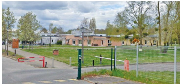
Les ailes n° 4 et n° 5 de l'EHPAD du Chemin de la Rose ont dû être condamnées suite à l'effondrement d'une corniche.
