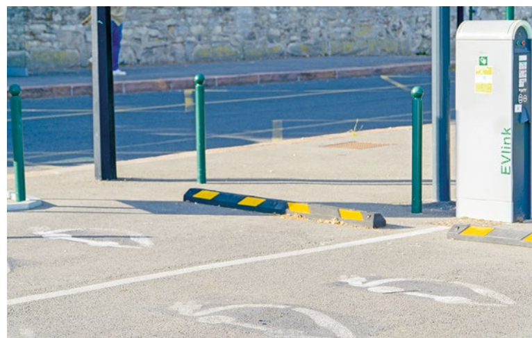
Sur les 73 communes de GPSEO, 43 devraient être équipées de bornes avant la fin de l'année. Chaque borne possède deux points de charge.
