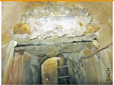
La conduite d'évacuation de la rue Maurice Berteaux (photo) est en mauvais état.
