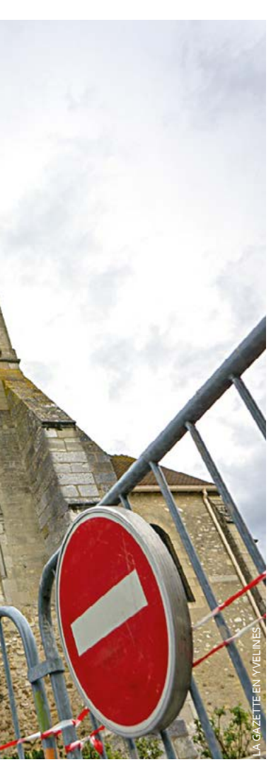
La chute de colonnettes situées au pied de la flèche a entraîné la mise en place d'un périmètre de sécurité, à l'intérieur comme à l'extérieur.
