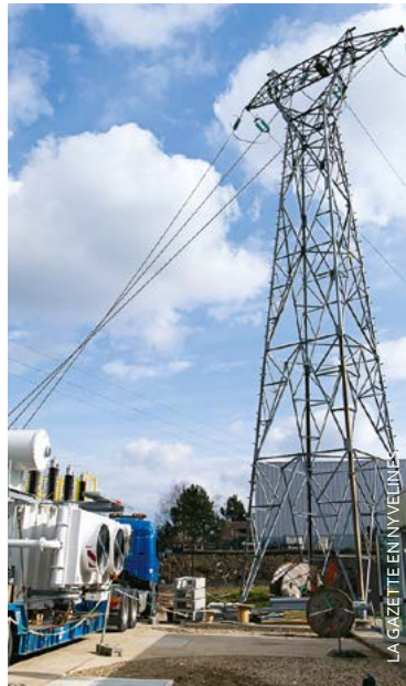
Un troisième transformateur a été installé au poste source de Magnanville, en bas à gauche sur la photo.
