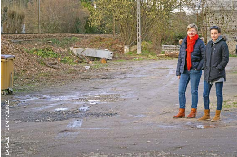
Comblir la route avec des gravillons n'empêche pas les trous de se reformer.
