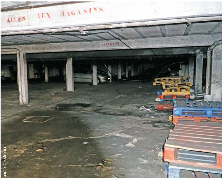
Le centre commercial La Source a subi deux incendies en une semaine, avec plusieurs foyers. Tous se sont manifestés à l'intérieur du parking situé au sous-sol.
