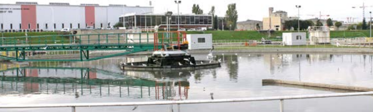
Un des bassins de traitement des eaux usées du SIAAP
